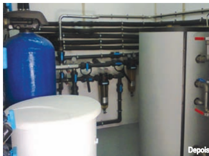
Central de tratamento de águas
